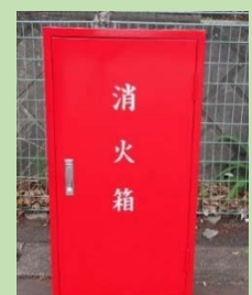
初期消火箱（固定式）
